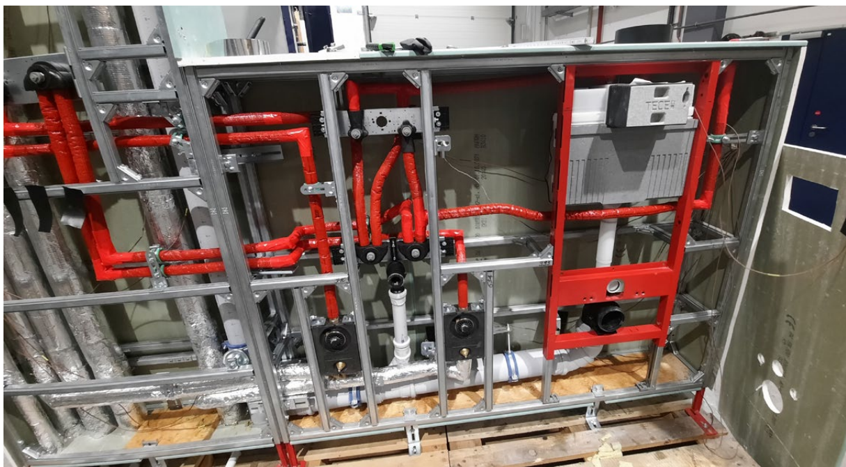
Offene teilhohe Installationswand mit Wasserzähler, Doppelwandscheiben für Thermostatarmatur und Waschtisch und WC-Modul mit Hygienspülung
