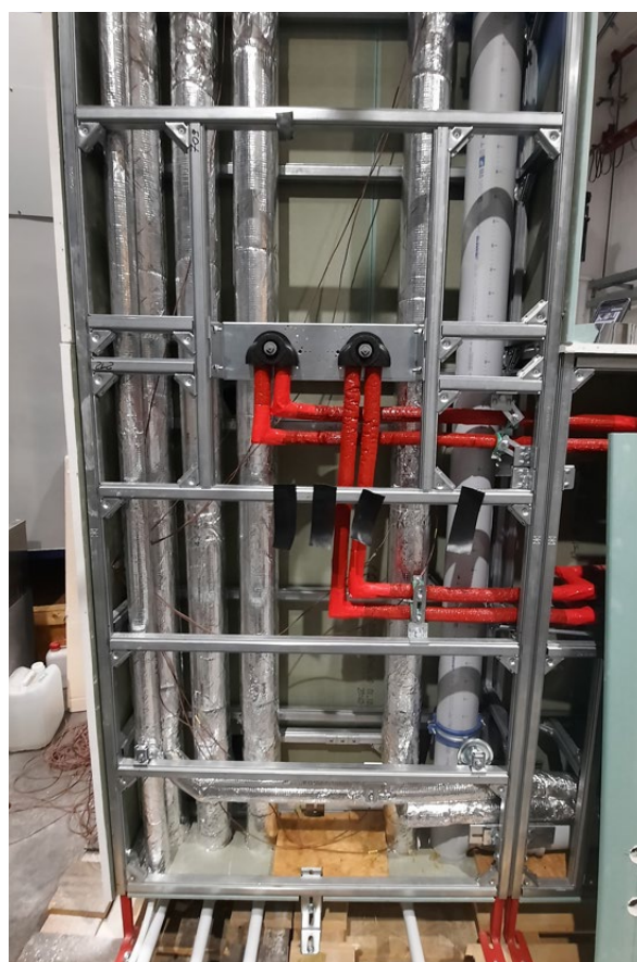
Rück- und unterseitig beplankter Installationsschacht mit den gedämmten warmgehenden Steigleitungen links, der Duschtraverse und den daran angebotenen Etagenleitungen in der Mitte und der gedämmten Kaltwassersteig- und Schmutzwasserleitung rechts
